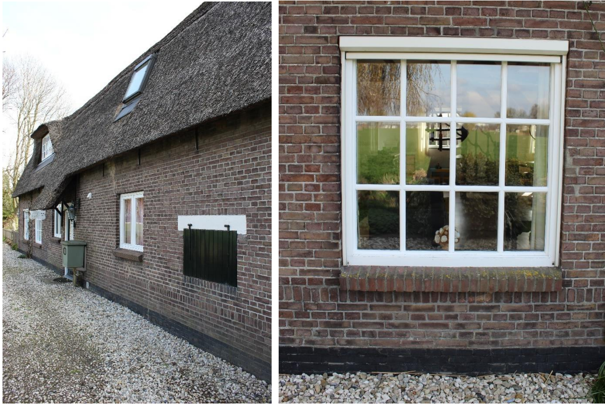
Figuur 11: Links: opname van de rechter zijgevel in de richting van de Tiendweg. Rechts: één van de vermaakte gevelopeningen.
