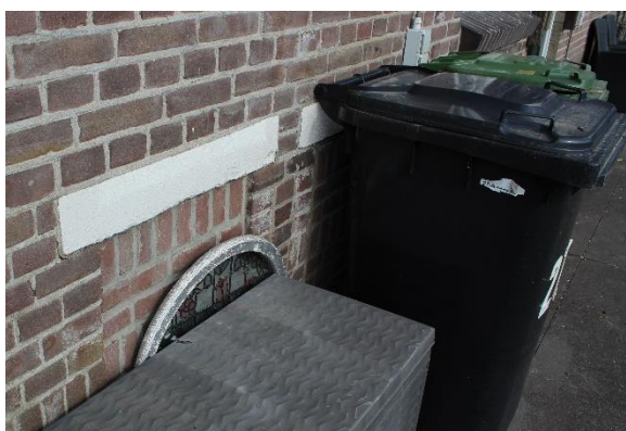
Figuur 10: Opname van de linker zijgevel in de richting van de Tiendweg. Alle gevelopeningen zijn vermaakt of toegevoegd. De detailfoto toont één van de dichtgezette doorgangen.
