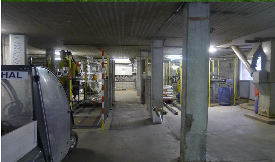
Inpandige afzakinstallatie in kelder hoofdgebouw (loods 5) (akoestisch niet relevant voor omgeving)
