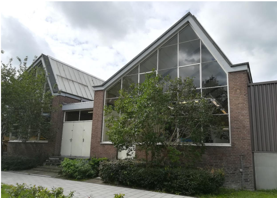
Foto 4. Oostzijde Schoonhovens College: de praktijklokalen hebben een 'zaagdak' met lichtstraten en bitumen dakbedekking. De loodslabben bij de aansluiting met de lagere halletjes vertonen kieren. De trappen zijn dermate verzakt dat er kieren zijn ontstaan waar rugstreeppadden een winterplek kunnen vinden.
