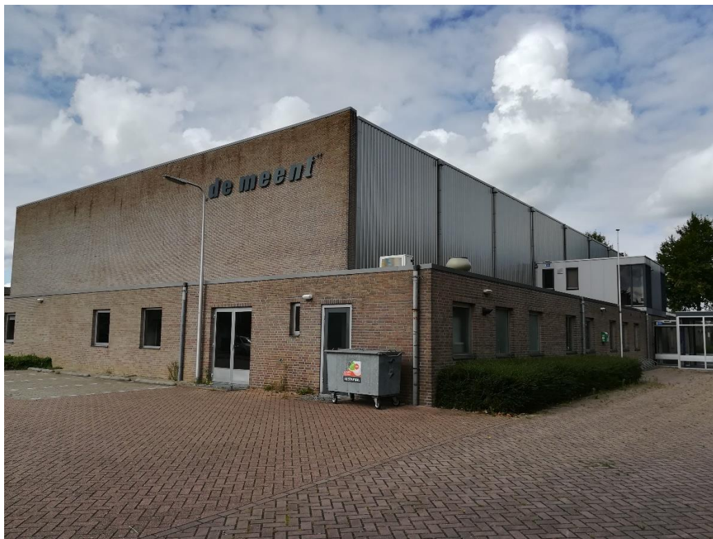
Foto 13. De sporthal gezien vanuit het noorden. De dilatatievoegen van deze gevel vertonen kieren door het ontbreken van specie. De dakrand van de, en de achterste gevel heeft ook diverse kieren, waardoor hier verblijfplaatsen van vleermuizen verwacht worden.
