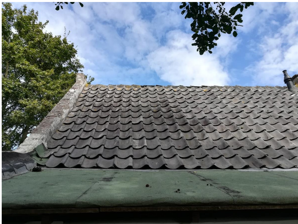
Foto 11. Dakconstructie van Opweg 84; de nokpannen en eerste rij pannen zijn afgesmeerd met specie. De pannen liggen direct op het dakbeschoot waardoor er geen ruimte is onder de pannen om te broeden. In de nok is een gat aanwezig, waardoor bijv. spreeuw de vliering kan bereiken om te broeden.
