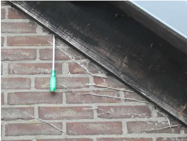
Figuur 22 Geen ruimte houten gevelbekleding
