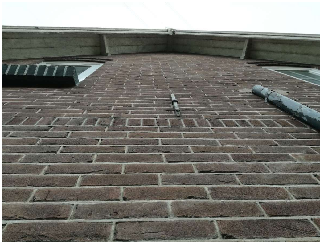
Foto 13. Tussen de dakoverstek en de muren van beide kopgevels, en langs de klosjes zijn kieren en gaten aanwezig, waardoor vogels en vleermuizen onder het dak kunnen komen.
