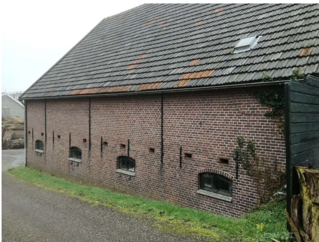
Foto 20. Zicht op de westelijke gevel van de schuur van Schuwacht 152 met een enorm dakoppervlakte en (van oudsher aanwezige) gaten in de muren. De ruimte onder de pannen is bereikbaar via de dakgoot. In de muren (zowel west- als oostgevel) zitten diverse scheuren.
