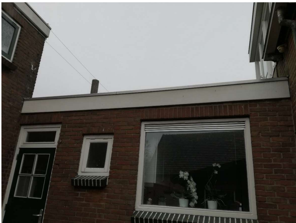
Foto 14. Tussen Schuwacht 150 en het bedrijfsgebouw is een kleine uitbouw aanwezig, die ook wordt gesloopt. De ruimte achter de daklijsten aan zowel de oost- als westzijde zijn bereikbaar voor vleermuizen door kieren onderlangs; in het geval van deze westelijke gevel boven de ramen.
