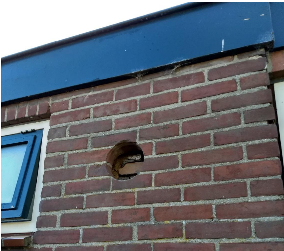
figuur 11: gat achterkant Schuwacht 46
