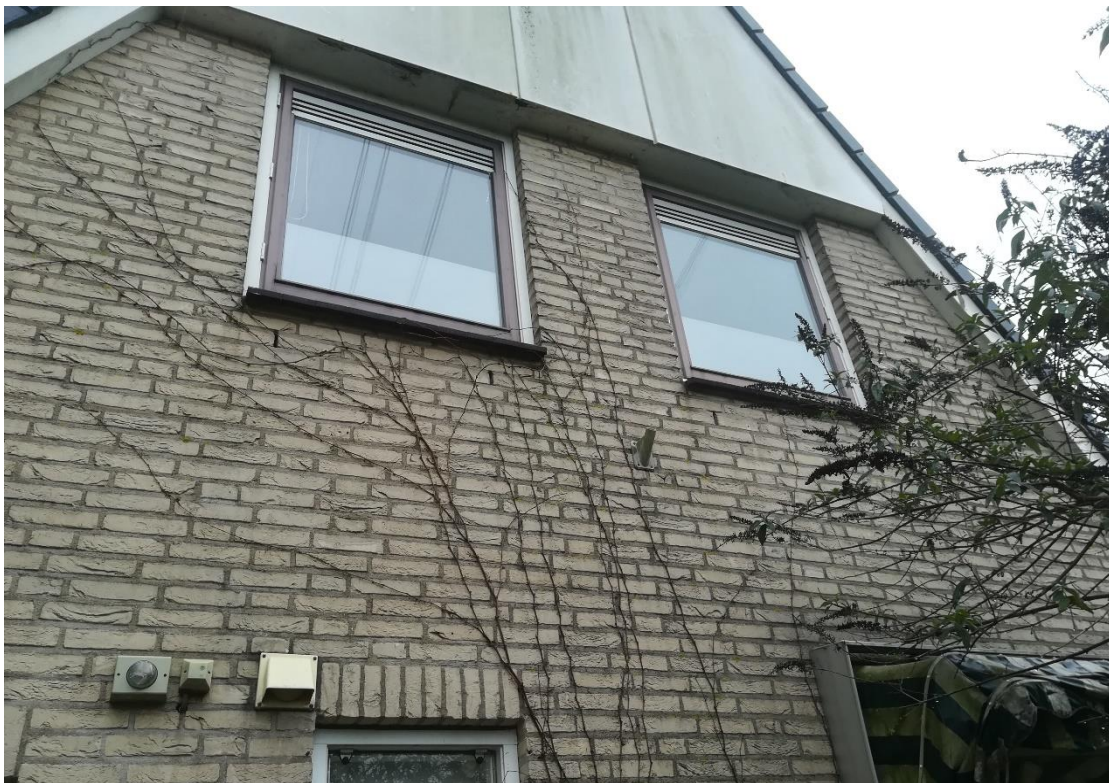
Foto 2. In zowel de voor- als achtergevel zijn twee open stootvoegen aanwezig, onder de ramen van de eerste verdieping.
