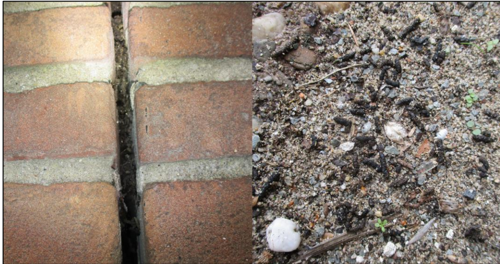
Figuur 3 Uitwerpselen van de gewone dwergvleermuis in een dilatatievoeg en de grond eronder.
