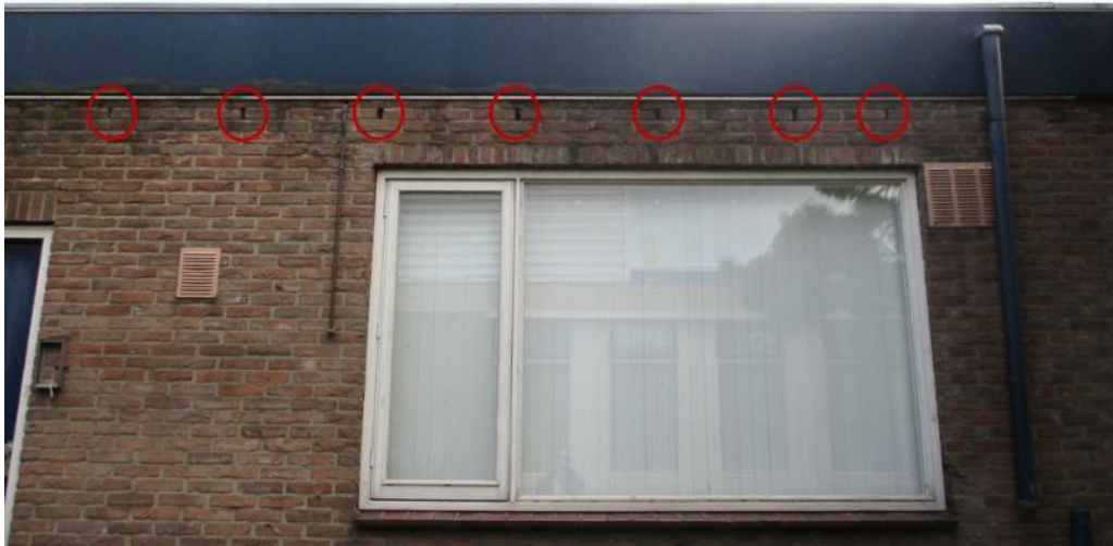
Figuur 2 De aanwezige open stootvoegen welke toegang verlenen tot de achterliggende geïsoleerde spouwmuur.
