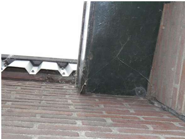
Figuur 10. Onderaanzicht van de gevelplaten en dakgoot. Er zijn geen spleten of kieren beschikbaar voor Gierzwaluw of vleermuizen.
