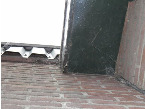
Figuur 8. Onderaanzicht van de gevelplaten en dakgoot. Er zijn geen spleten of kieren beschikbaar voor Gierzwaluw of vleermuizen.
