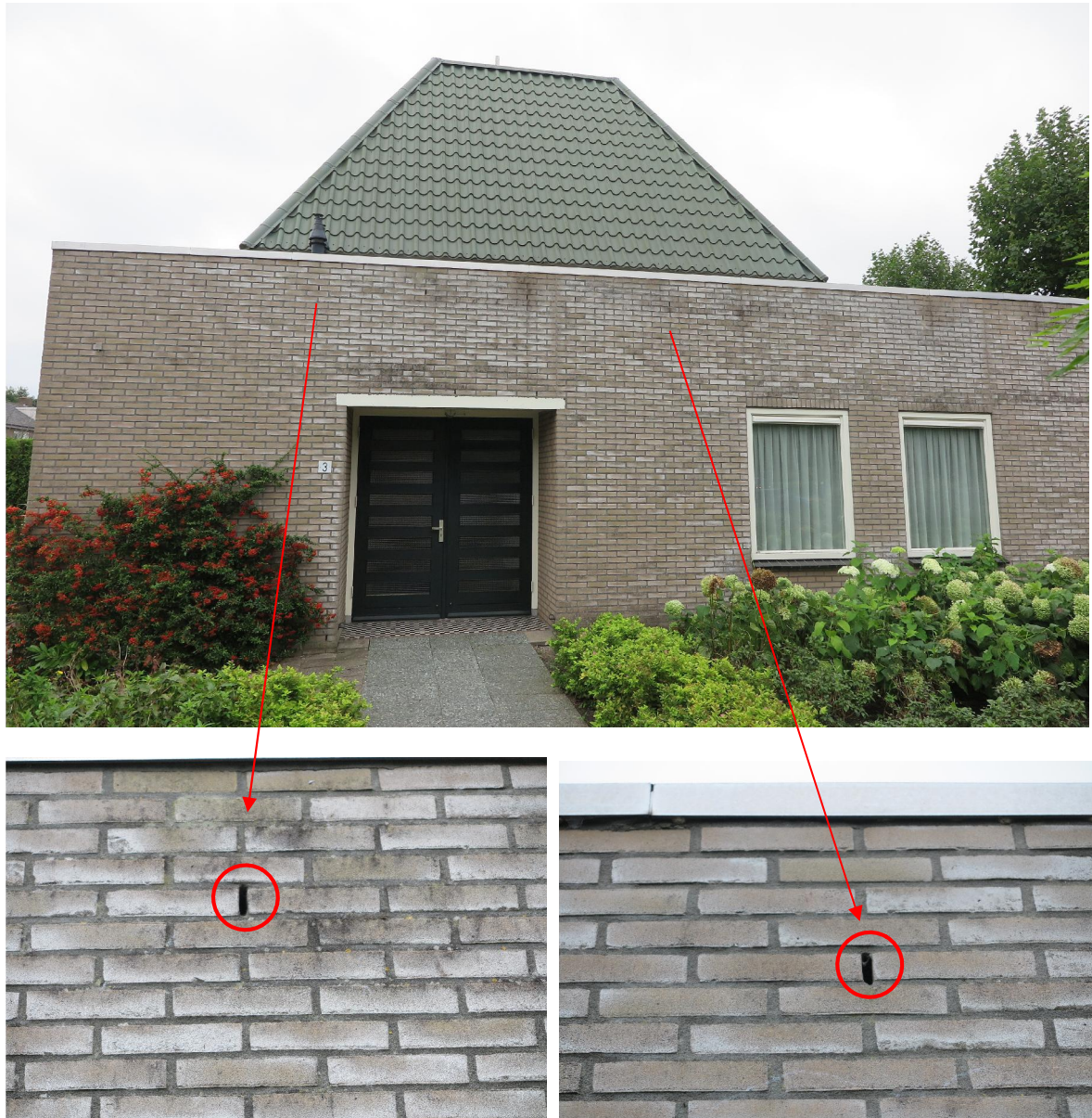
Figuur 5. Niet geschikte beluchtingsgaten voor vleermuizen.
