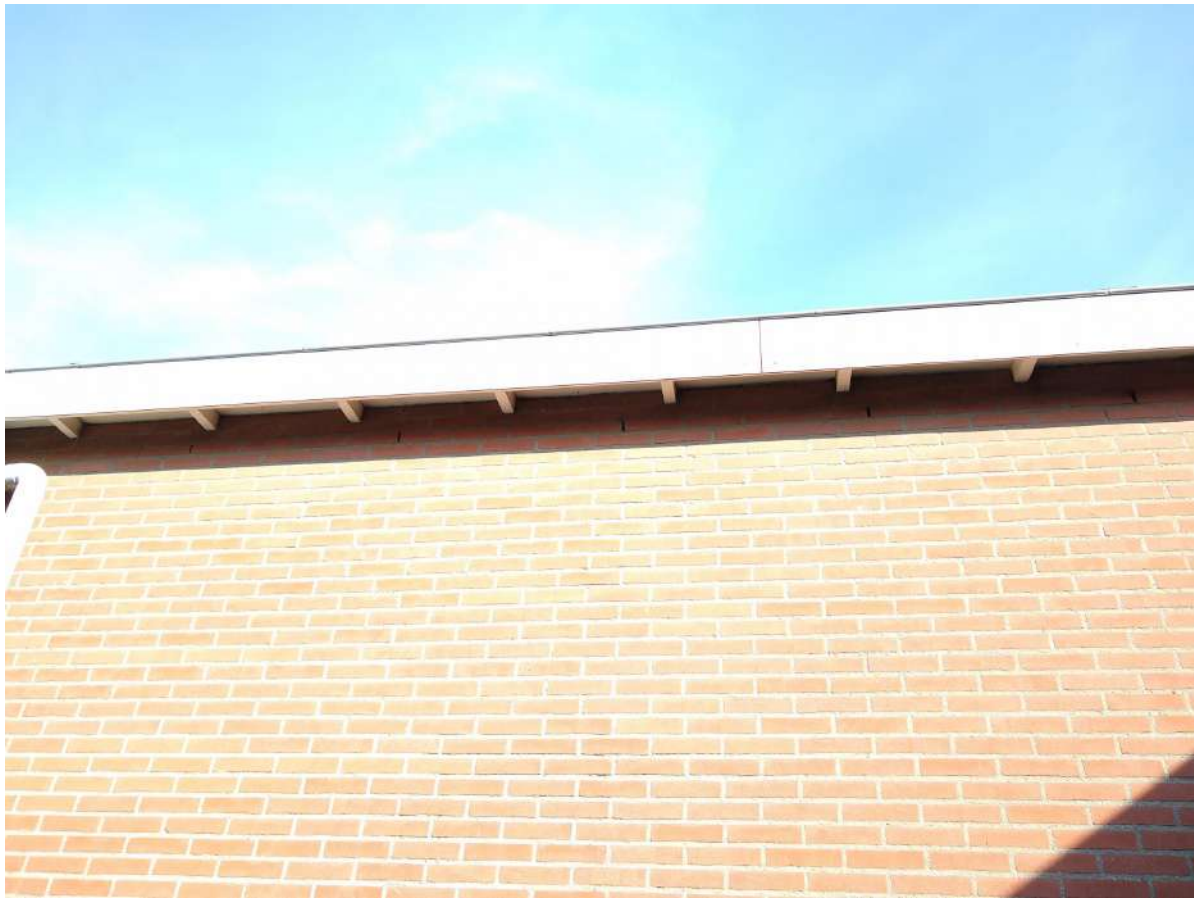
Afbeelding 8: Dakrand met eronder stootvoegen aan de westgevel.
