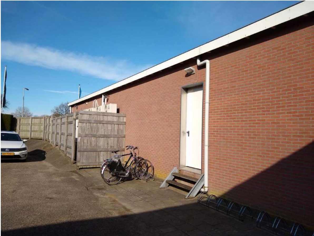
Afbeelding 7: Dakrand met eronder stootvoegen aan de westgevel.
