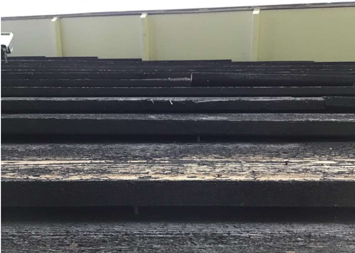
Afbeelding 24: Lossen houtplanken aan de zuidgevel.
