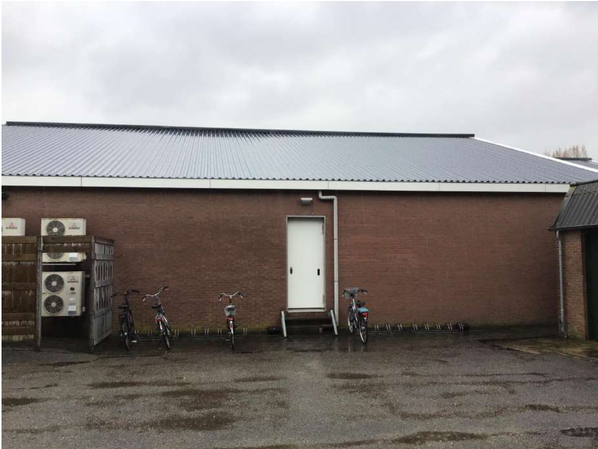
Afbeelding 31: Dakrand met eronder stootvoegen aan de westgevel.
