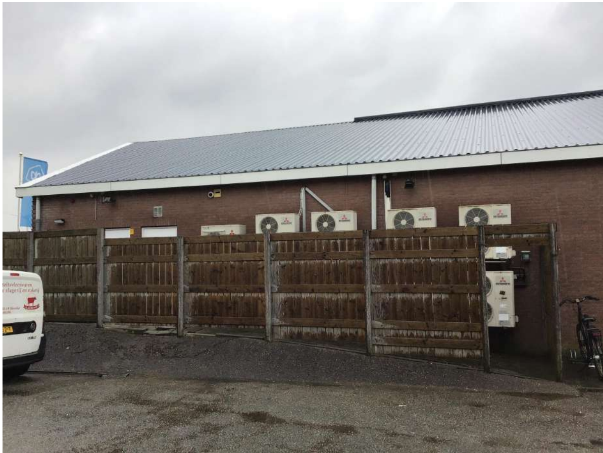
Afbeelding 32: Dakrand met eronder stootvoegen aan de westgevel.
