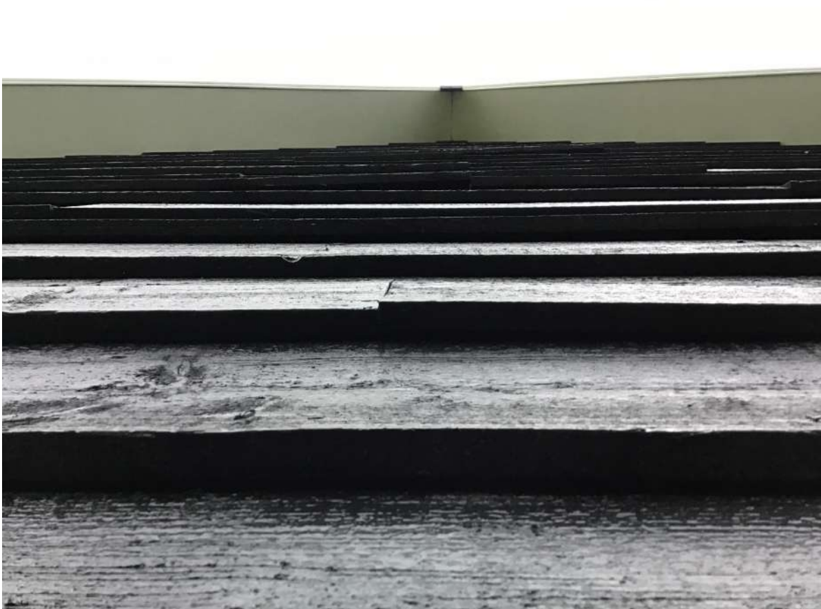
Afbeelding 37: Lossen houtplanken aan de zuidgevel.
