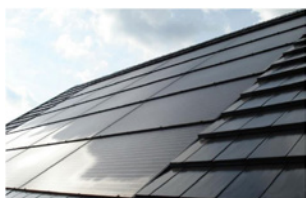
Zorgvuldig geïntegreerde zonnepanelen
