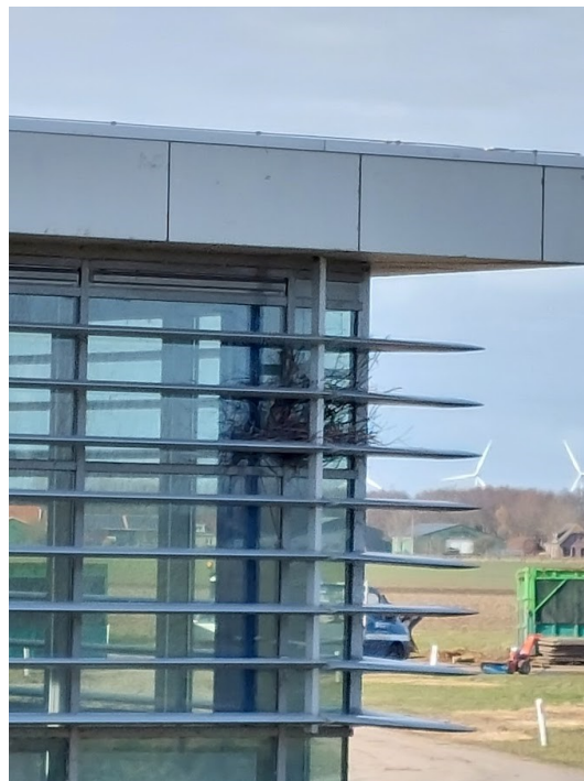
Figuur 4-2: Nest tussen spijlen gebouw station.
