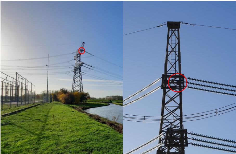
Figuur 3.3 Mast 068 nest in bovenste traverse wit
