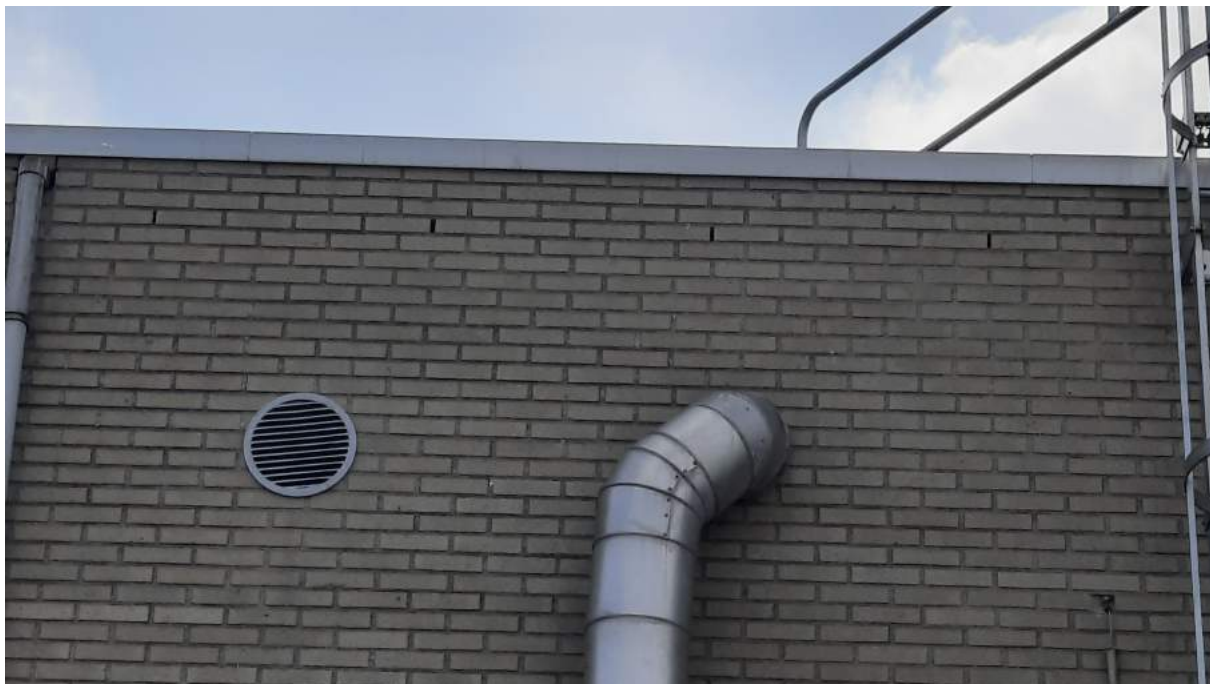
Open stootvoegen in de muur die als invliegopening voor vleermuizen kunnen dienen. Foto: M.M. Bouwmeester | Ecoresult B.V.
