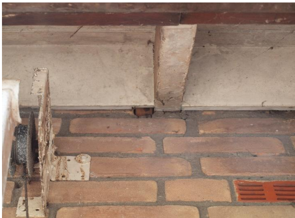
Figuur 5. Kleine opening tussen dak en muur aan de achterkant van de woning.
