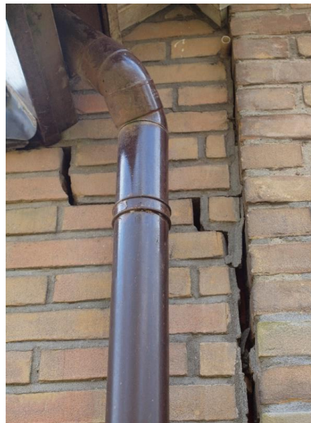
Figuur 6. Scheur ontstaan door verzakking uitbouw aan zijkant van de woning.
