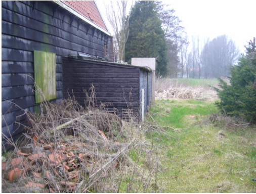
afbeelding 7. Heullaan 30 (dakbedekking schuur verdacht op
