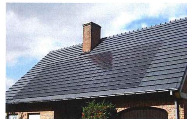
Zonnepanelen geïntegreerd in het dak; donkere dakbedekking
