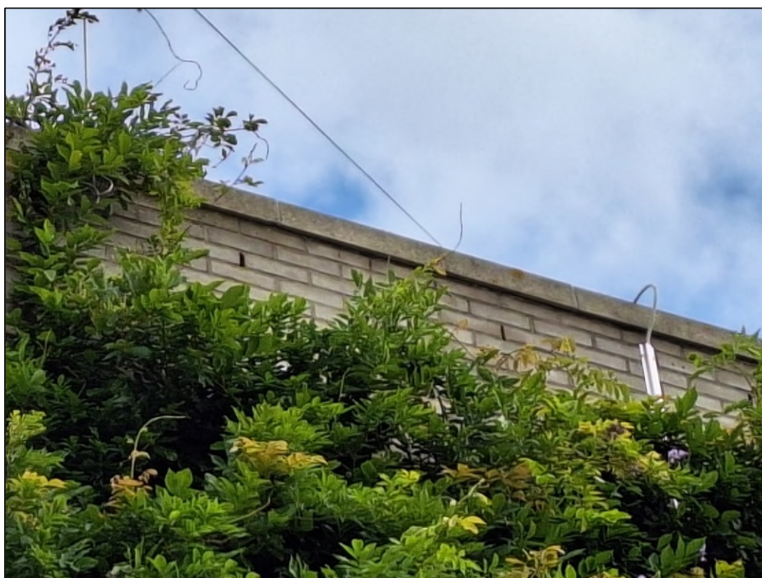
Figuur 2.3. Gaten in de muur van het bijgebouw. Gaten zijn onwaarschijnlijk groot genoeg om nestmogelijkheid te bieden voor gebouwbroedende vogelsoorten.
