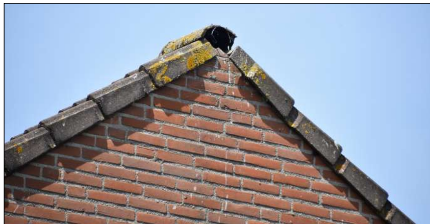
Figuur: bij de omliggende woningen zijn op diverse plaatsen openingen onder kant- en nokpannen aanwezig. Hier kan gierzwaluw tot broeden komen en vleermuizen kunnen er verblijfplaatsen hebben.
