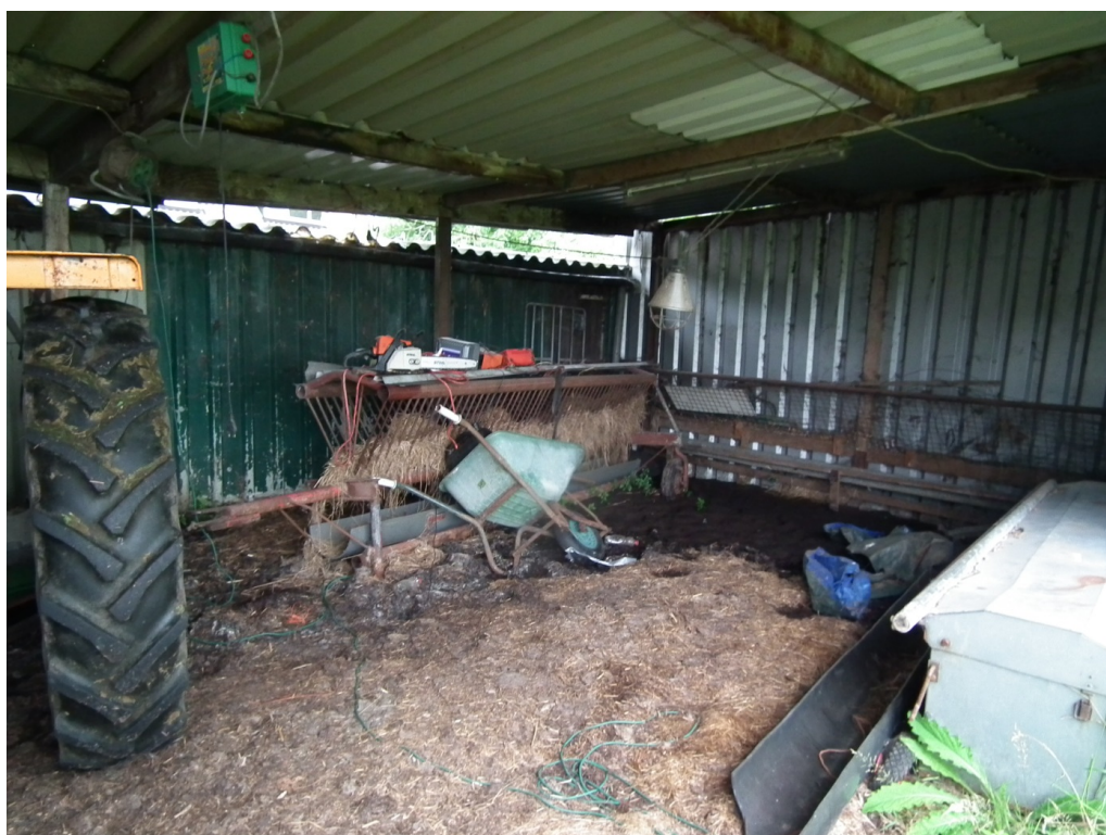
Figuur 2 De locatie betreft een hondenkennel. De schuurtjes zijn opgetrokken uit damwandplaten, hout, golfplaten en eternit platen.
