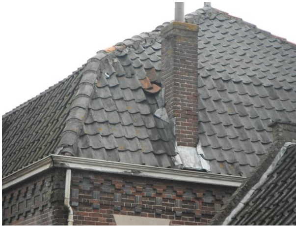
Het huis is in slechte conditie
