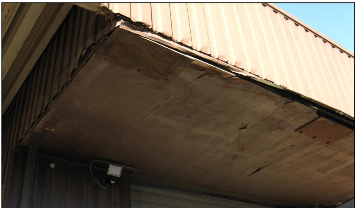
Foto 2: Dakrand van een deel van de loods met de vele kieren en gaten geschikt voor vleermuizen.
