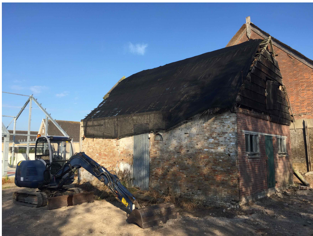
Figuur 3 De schuur achter de woning verkeert in zeer slechts staat. Het dak en de verdiepingsvloer zijn op divers plaatsen kapot. De schuur heeft derhalve momenteel geen functie.
