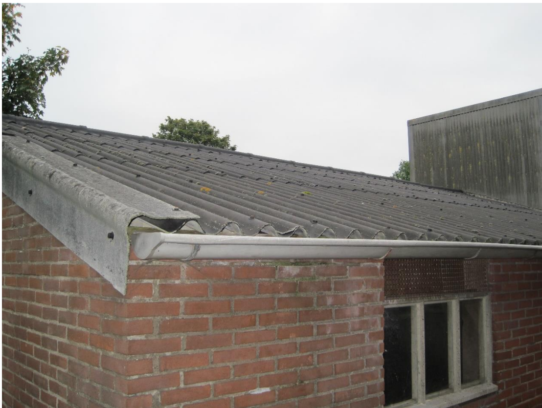
Afbeelding 16: Asbesthoudende dakplaten varkensschuur
