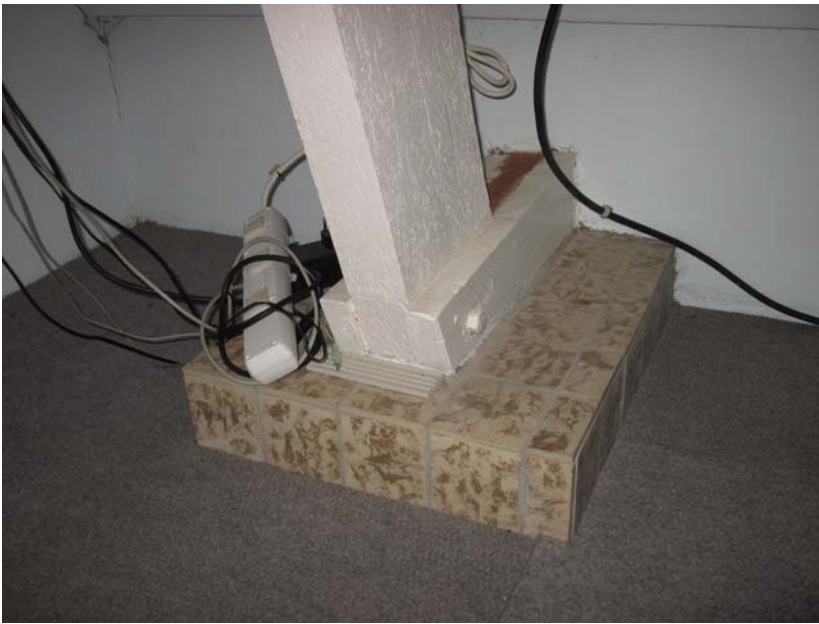
Ruimte 13 _ werkkamer 2 Door het verhogen van de verdiepings- vloer is het blokkeel net boven de vloer komen te zitten.
