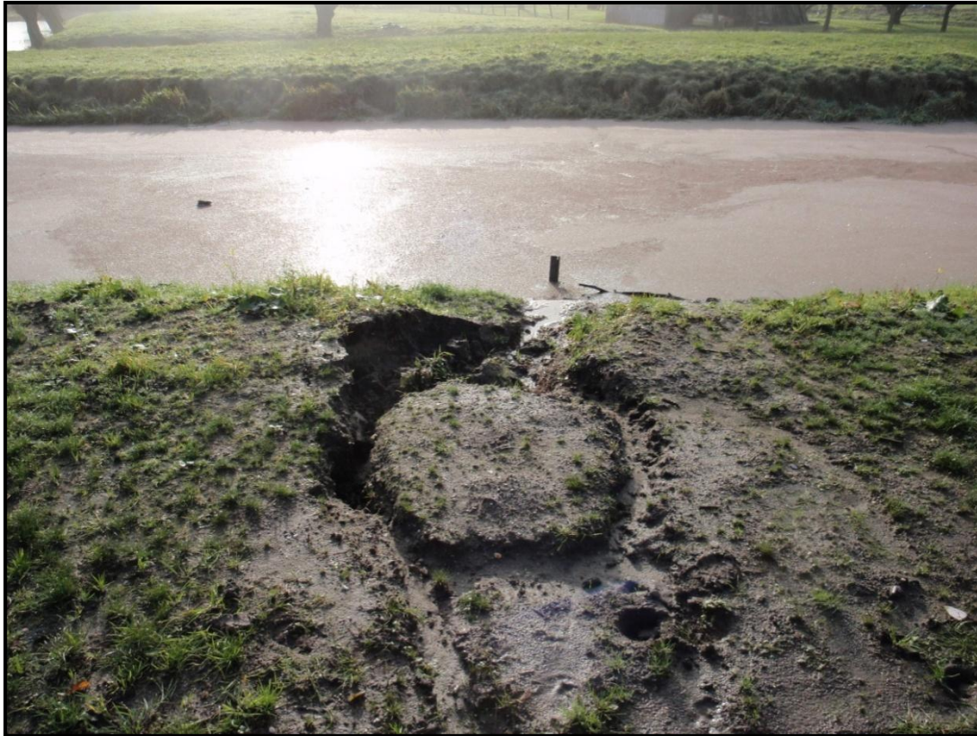
Figuur 9: Plaatselijk is de grond met zand opgehoogd of verstevigd. Dit is zichtbaar in het maaiveld en doordat delen de sloot in spoelen tijdens regenbuien.
