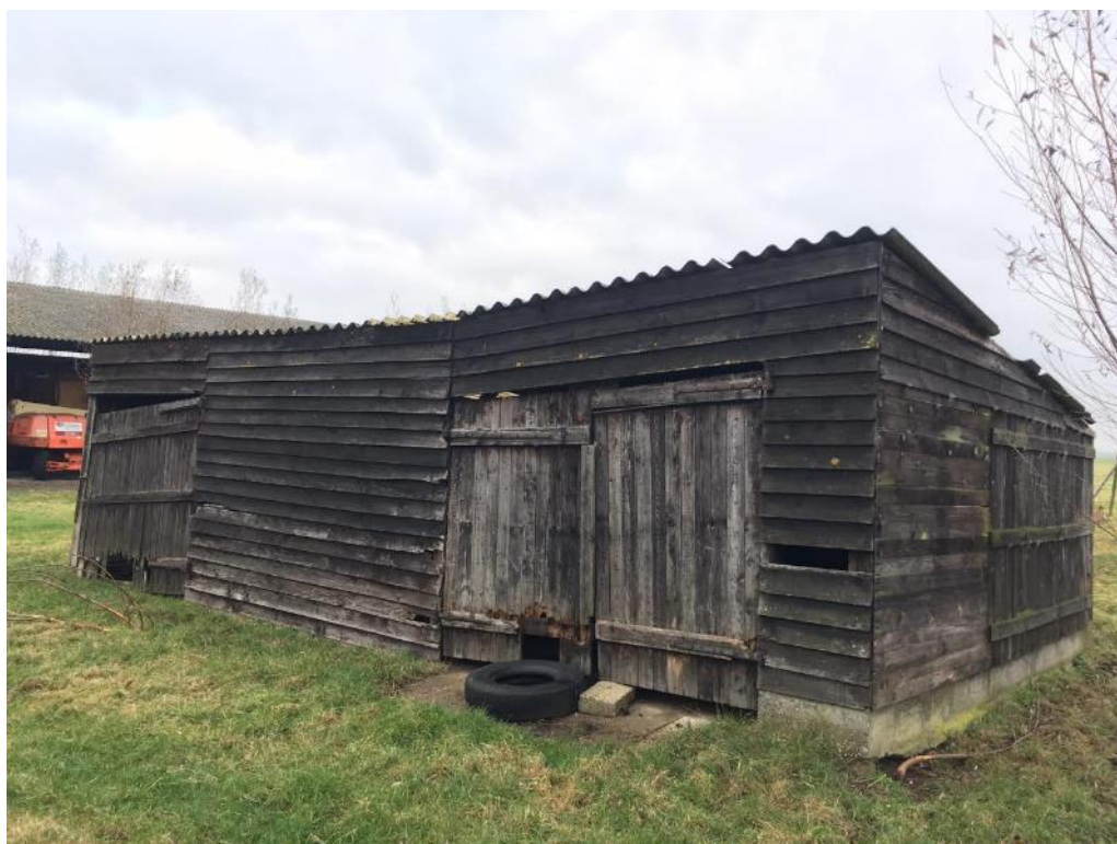
Figuur 3 De te slopen schuur verkeert in een slechte staat van onderhoud.
