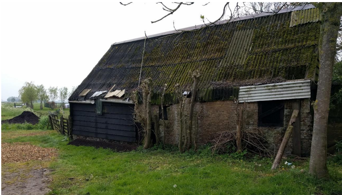
Afbeelding 4: Verouderde schuur perceel C 76
