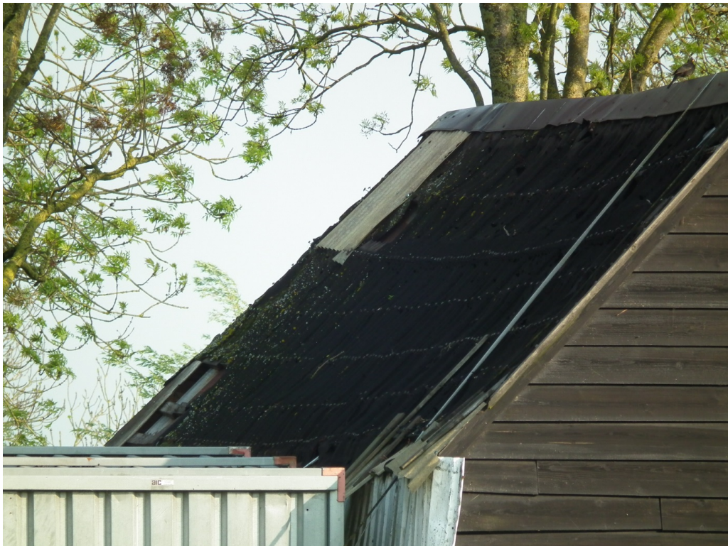
Figuur 4 De schuur verkeert in een dermate vervallen staat en is meermaals gerepareerd.
