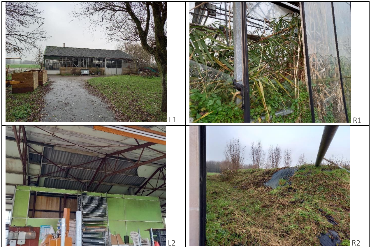
Figuur 5. Huidige situatie Nieuwkoopseweg 46a (L1 – voorruimte van de kas vanaf de Nieuwkoopseweg, L2 – ontbrekende plafondplaten voorruimte, R1 – Ontbrekende kasruiten, R2 – begroeid waterbassin)
