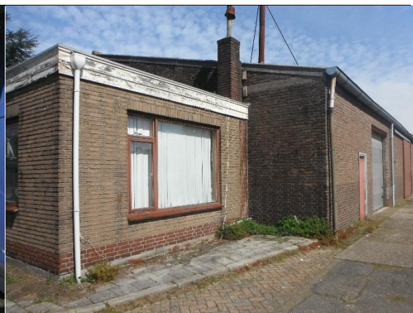
westzijde grote loods en bijgebouw, de slechte staat van onderhoud is duidelijk te zien (afbladderende verf)
