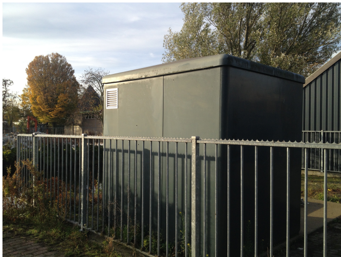
f2.2 Riolgemaal aan Spui 12 te Delfgauw
