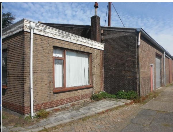
westzijde grote loods en bijgebouw, de slechte staat van onderhoud is duidelijk te zien (afbladderende verf)
