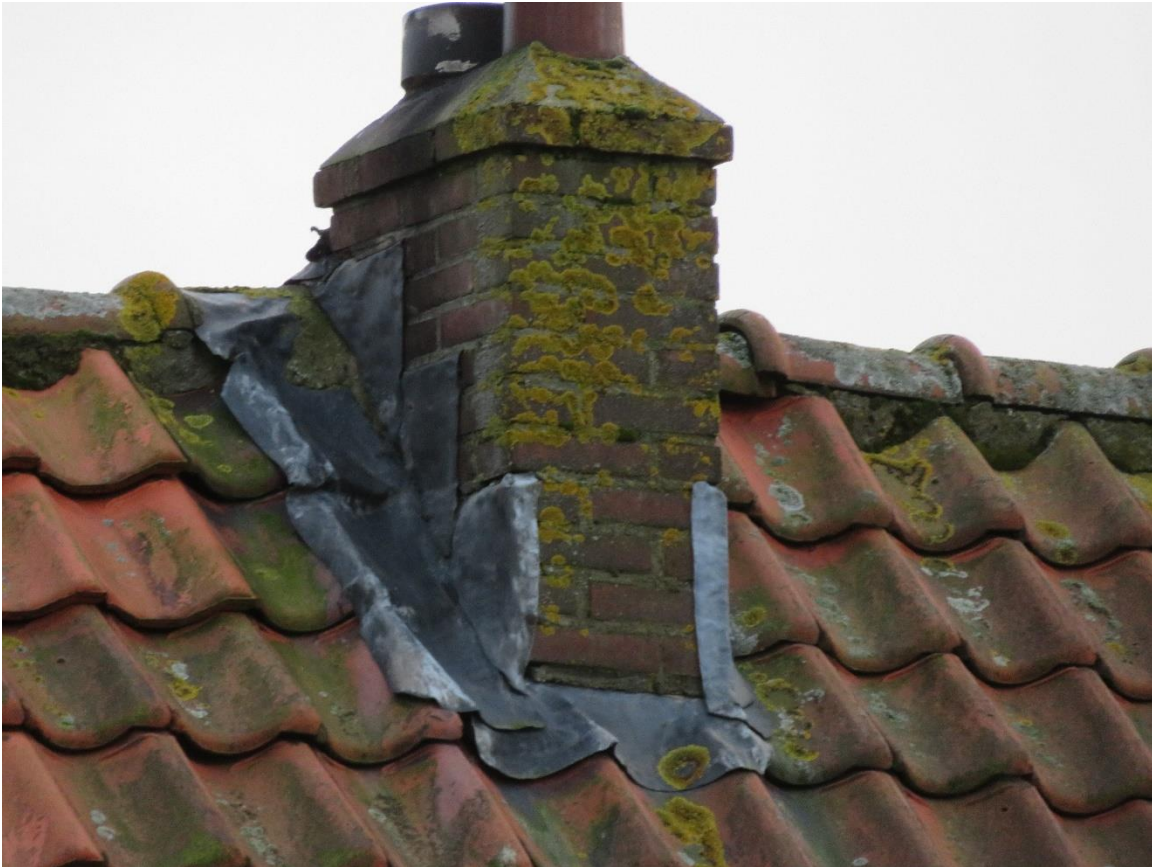
Geen ruimte bij de loodslab en vast gemetselde nokpannen.
