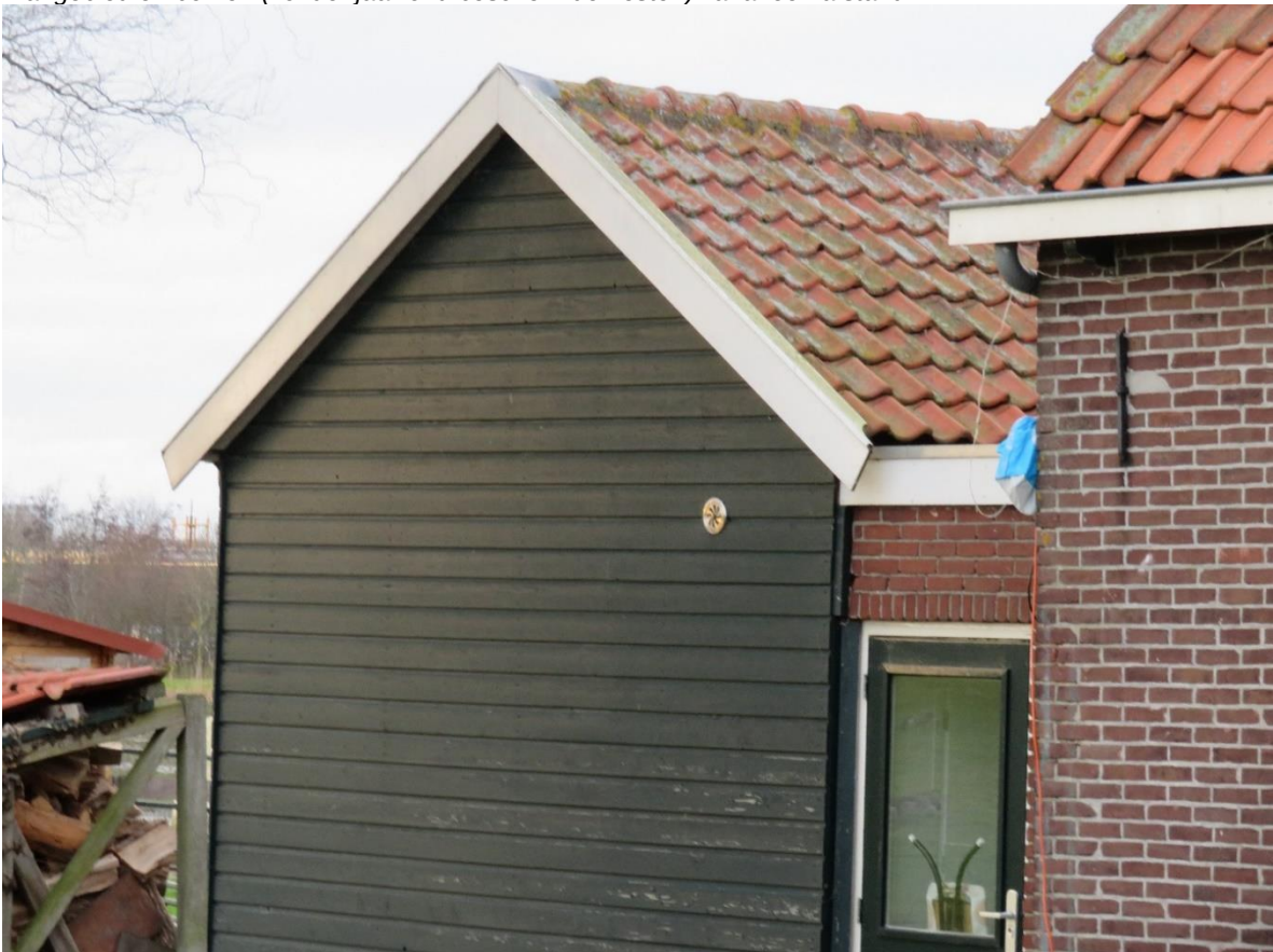
Aansluiting aanbouw op woonhuis. Ook hier zijn geen invliegopeningen voor vogels of vleermuizen aanwezig.
