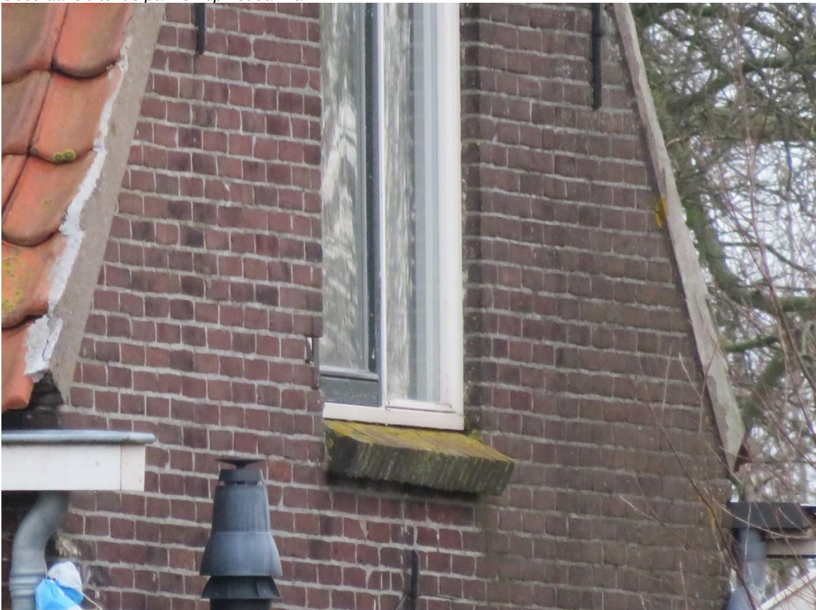
Stucwerk tussen kantpannen en gevel aan de achterzijde. Geen ruimte aanwezig voor vleermuizen.
