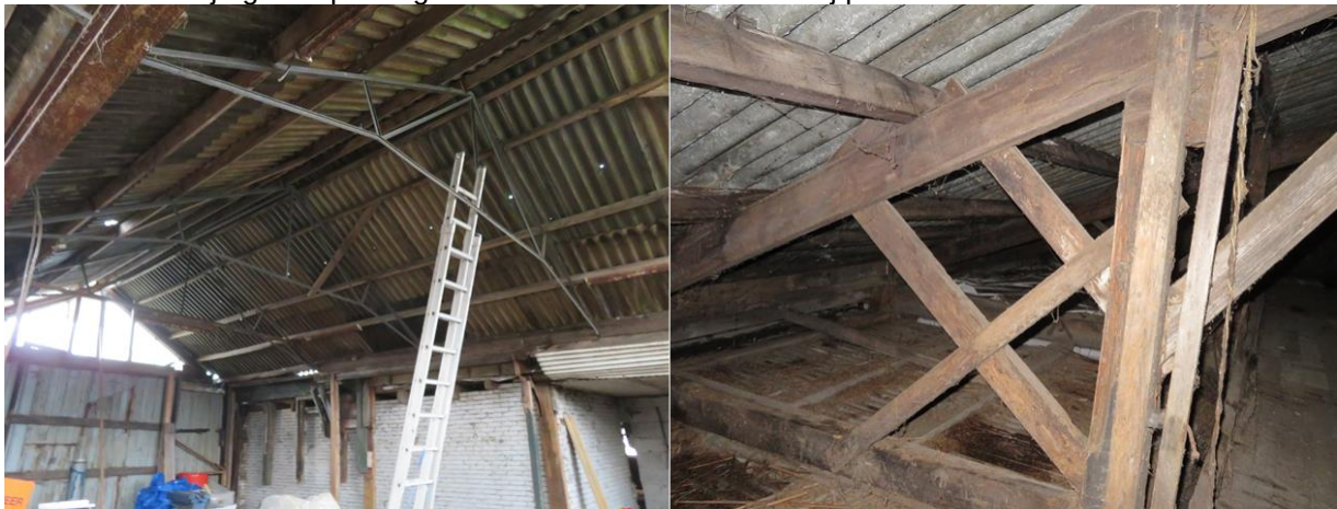
Afbeelding 6: foto's van de balken die het asbestdak dragen.
