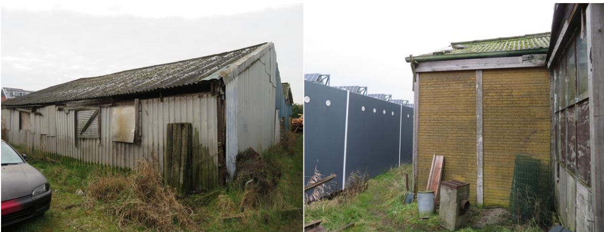
Afbeelding 6: Foto's van de met enkel plaatmateriaal vervaardigde schuren. Kieren en gaten zijn overal aanwezig.
