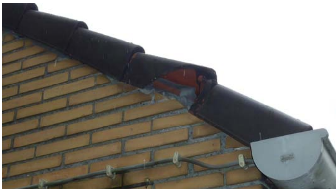
Foto 5. Gebroken gevelpan noordwestzijde.
