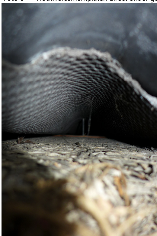
Foto 8 Houtwolcementplaten direct onder golfplaten
