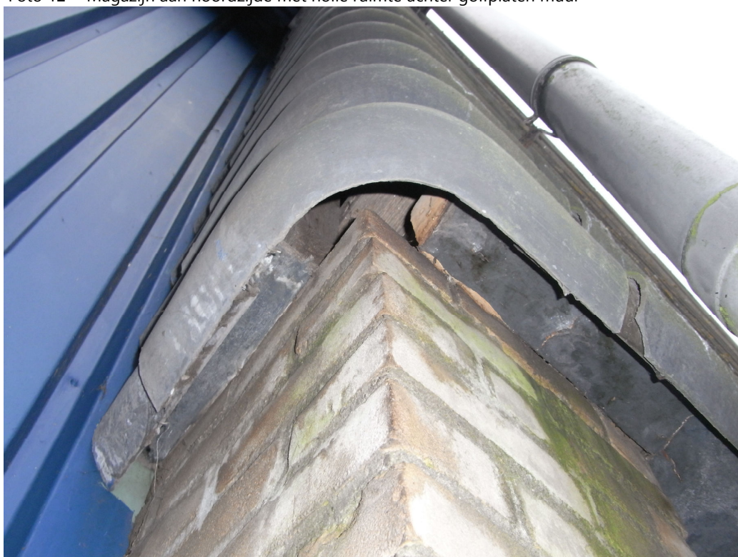
Foto 12 Magazijn aan noordzijde met holle ruimte achter golfplaten muur
