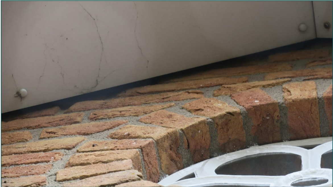
Figuur 3.1 Op diverse plaatsen in de woning zijn kieren aanwezig tussen de boeiboorden en de muur, waardoor zich mogelijk vleermuisverblijfplaatsen bevinden in de dakruimte.
