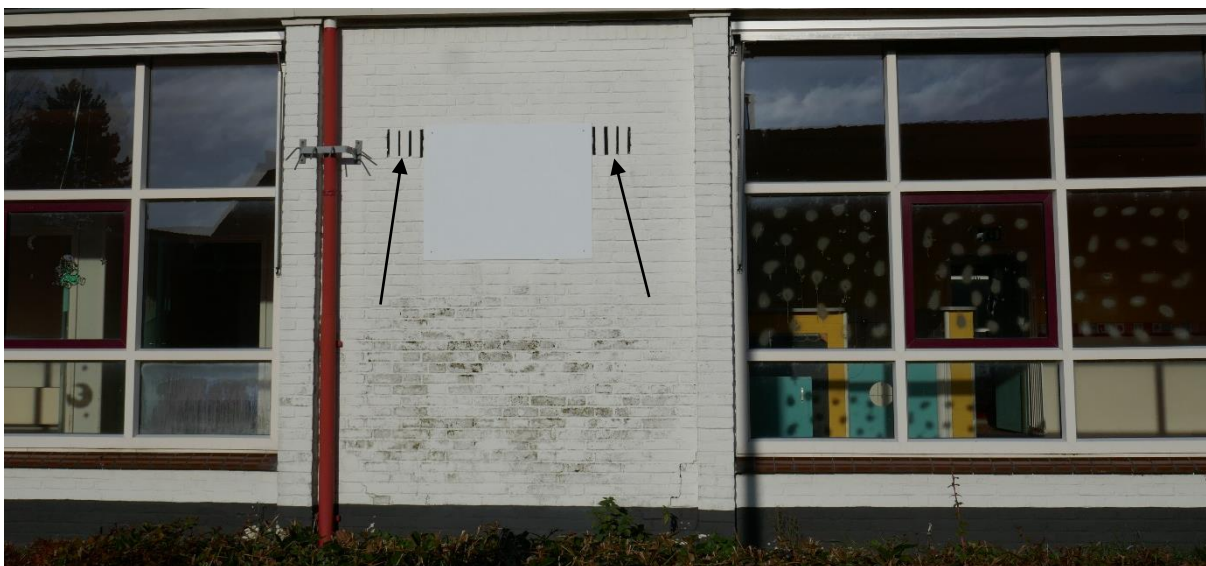
Foto 4: Open stootvoegen waar vleermuizen in kunnen kruipen
