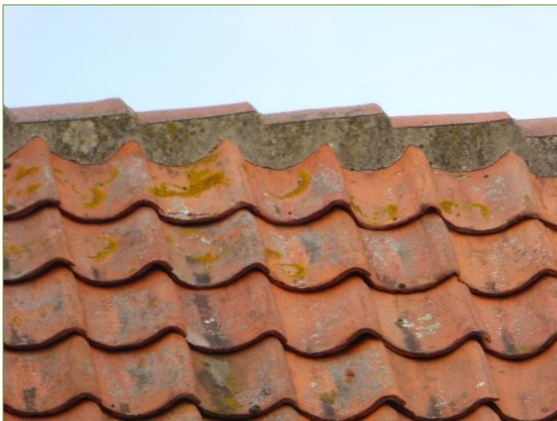
Foto 4: de dakpannen liggen mooi aaneengesloten en de nokpannen zijn allemaal dicht gemetseld en dus ongeschikt voor broedvogels of vleermuizen om onder weg te kruipen.
