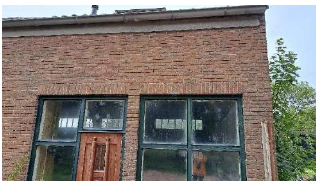
A. Open stootvoegen aan de zuidoostzijde van het pand.
