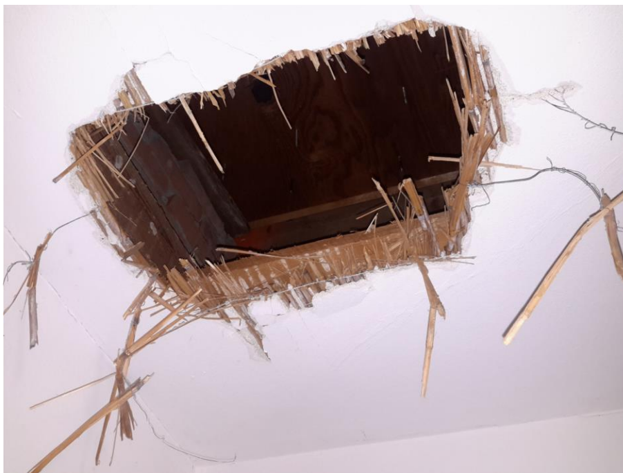
Foto F10, bitumen stelplaatjes - Plafond gehele oudbouw
