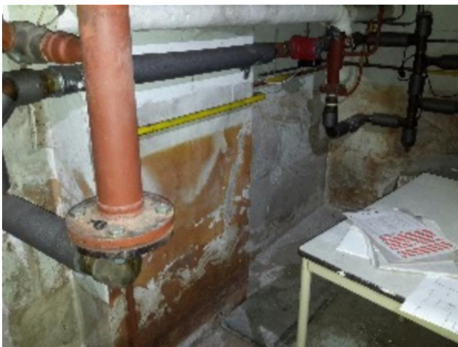
Foto F04, pakking - cv ruimte
