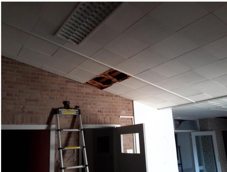
Foto F09, bitumen stelplaatjes - Plafond gehele oudbouw
