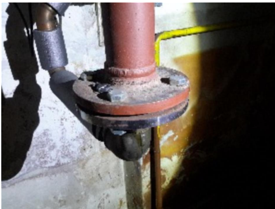
Foto F03, pakking - cv ruimte
