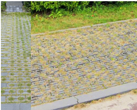
STRAATPARKEREN Parkeervakken in grasbeton.
