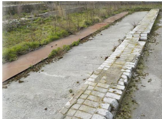
Foto 4. Fundatie van afgebrande schuur/stallen
