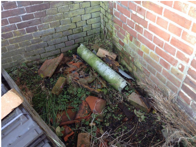
Buis van asbestverdacht materiaal
