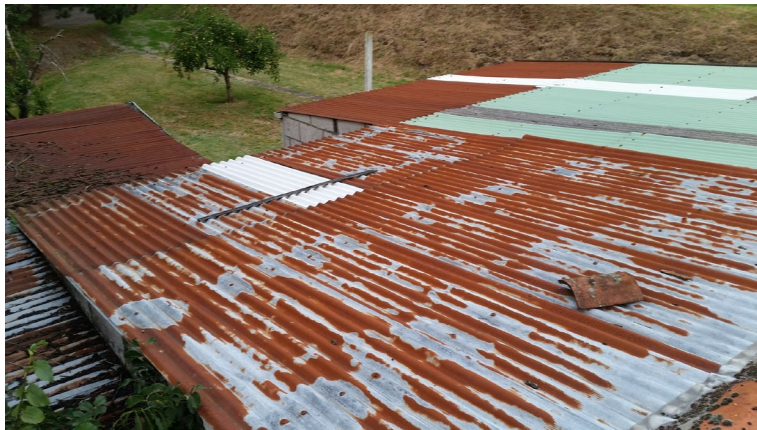
Afbeelding 23 | Locatie Kelderweg 25, verpauperde gebouwen 2017 (Bron: Initiatiefnemer)
