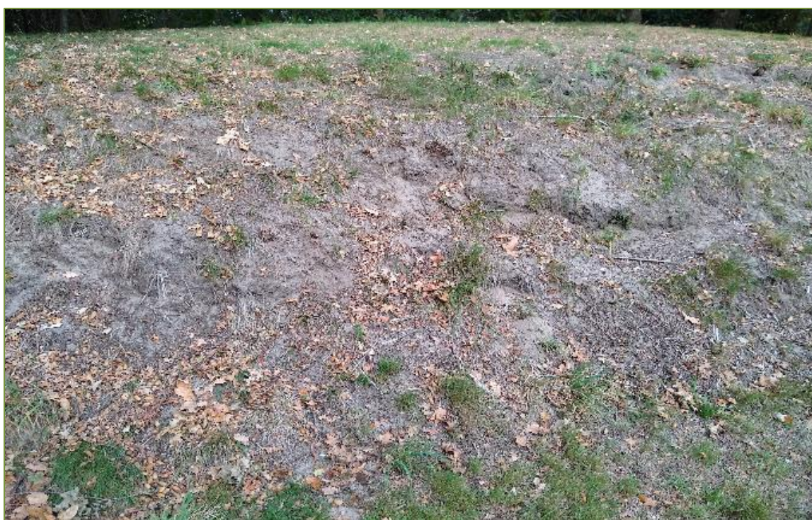
Foto 14: zandwal 2 is te schraal en hier en daar beschadigd waardoor de kans bestaat dat de zandwal gaat "leeg lopen". Herstel is noodzakelijk.
