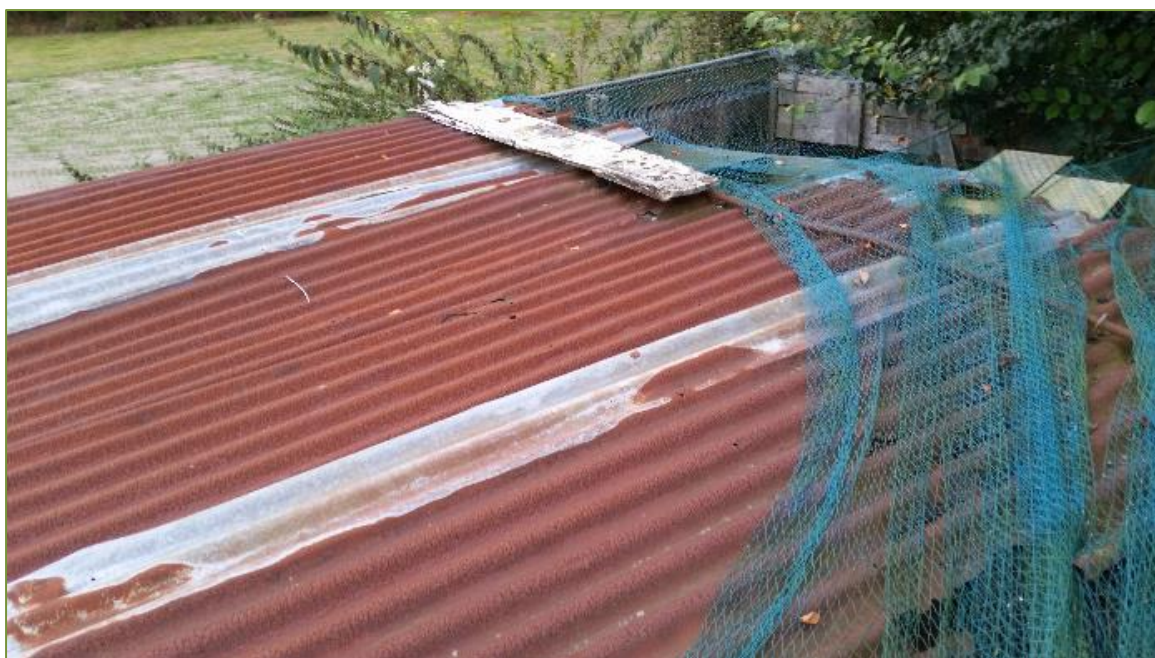
Foto 4: situatie bij aankoop, veel storende bouwmaterialen
