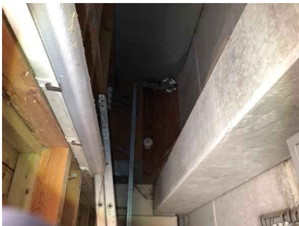
Gebouw A, meterkast
