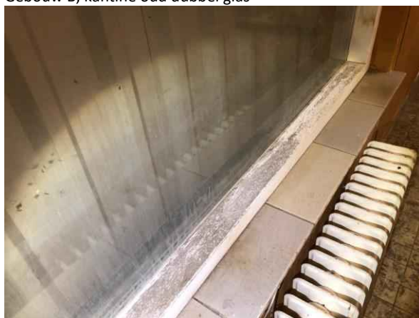
Gebouw B, kantine nieuw dubbel glas
