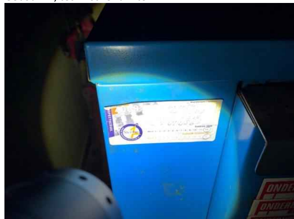
Gebouw B, technische ruimte
