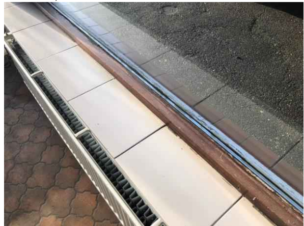
Gebouw B, kantoor oud dubbel glas
