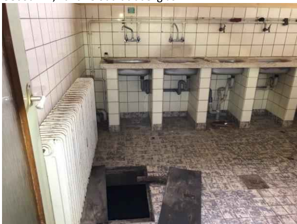
Gebouw B, wasruimte tegels en plavuizen
