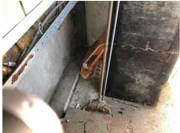
Gebouw A, meterkast
