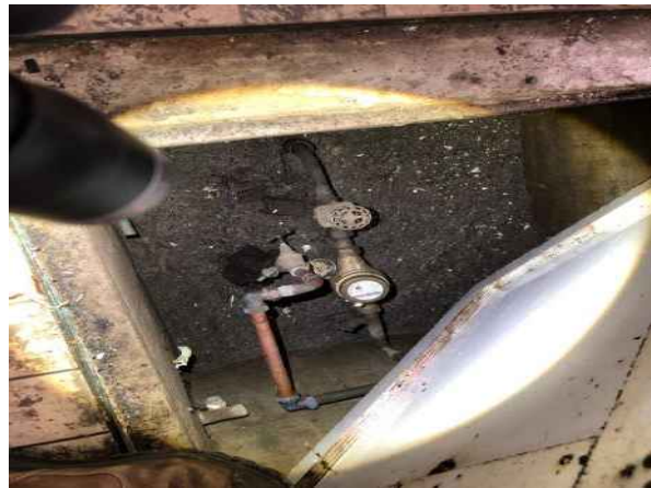
Gebouw B, entree waterput
