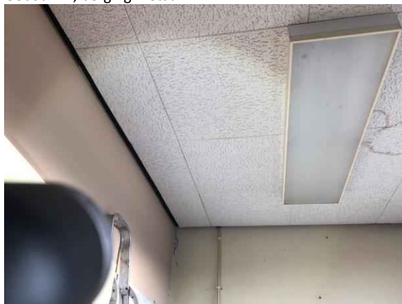
Gebouw B, systeem plafond
