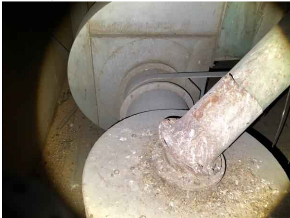
Gebouw C, installatie geen bijzonderheden
