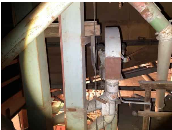
Gebouw C, installatie geen bijzonderheden
