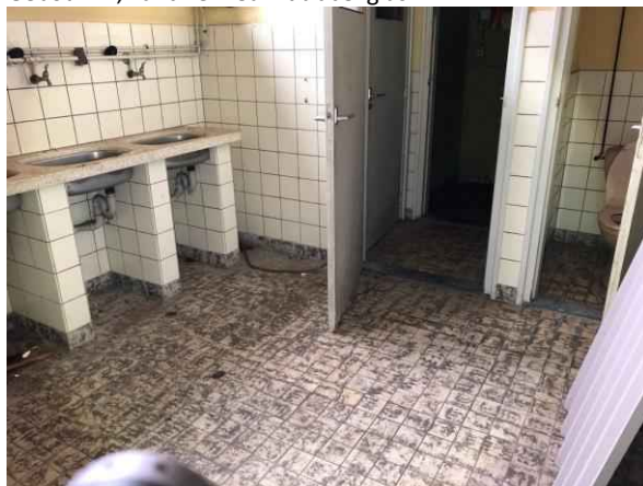
Gebouw B, wasruimte tegels en plavuizen
