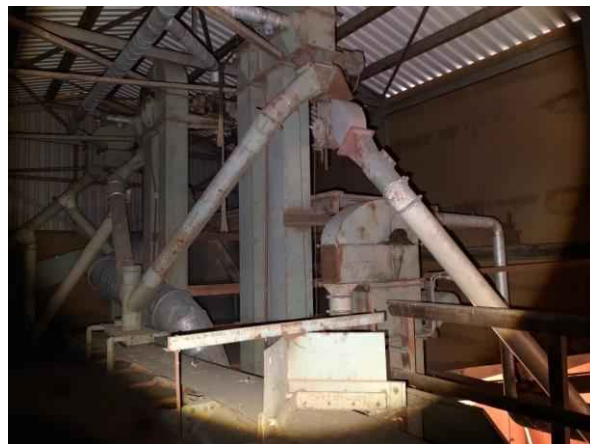
Gebouw C, installatie geen bijzonderheden
