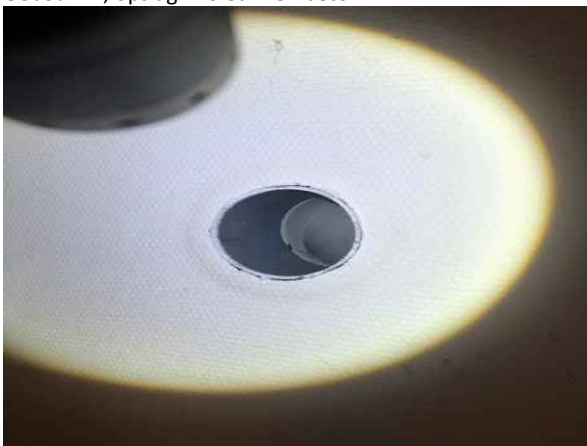
Gebouw B, opslag ontluftung pvc
