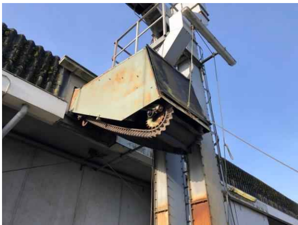
Gebouw A, technische installatie niet verdacht
