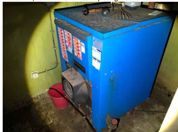
Gebouw B, technische ruimte
