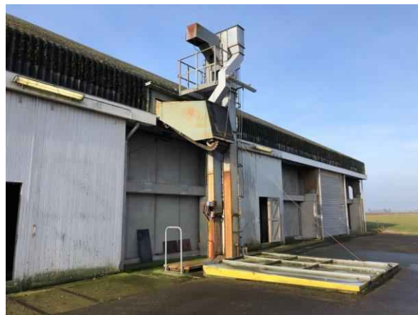
Gebouw A, technische installatie niet verdacht
