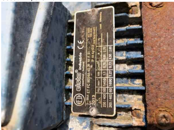
Gebouw A, technische installatie niet verdacht
