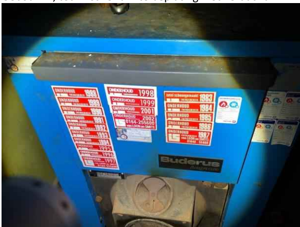
Gebouw B, technische ruimte
