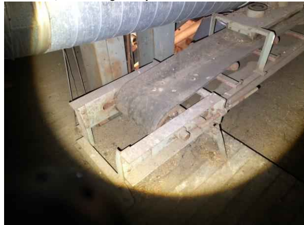
Gebouw C, installatie geen bijzonderheden
