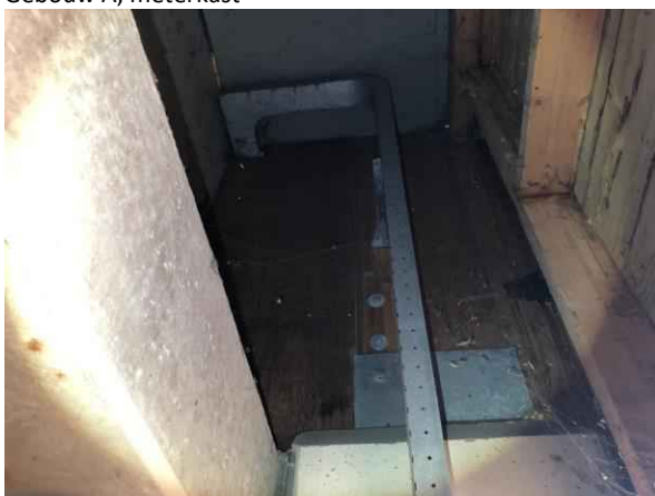
Gebouw A, meterkast
