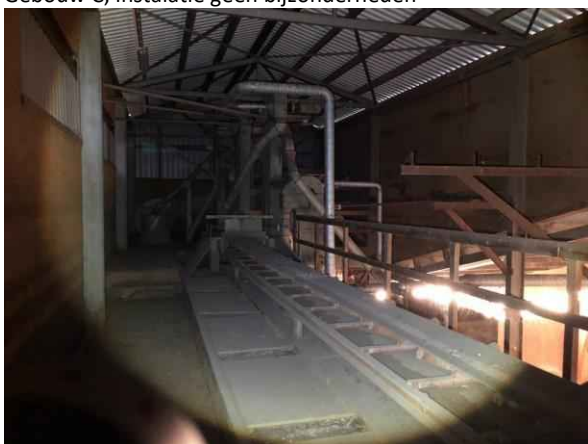
Gebouw C, installatie geen bijzonderheden
