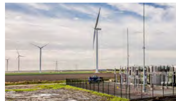
Illustratie 50kV transformatorstation, gelocaliseerd bij windmolen nr 4, aan de oostzijde van het kanaal.
